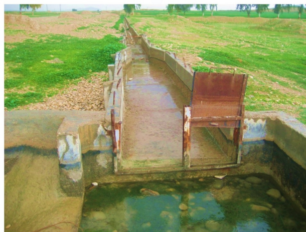
شکل ۴-۷- باکس تقسیم آب با دریچه‌های فرسوده، شبکه آبیاری مارون
